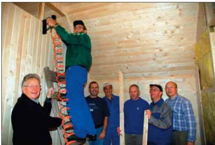
DUGNADSGJENG: Dugnadsgjengen har isolert vegger og lagt panel på flere rom under oppholdet i Ukraina. Fra venstre: Ivar Lyster, Finn Steinar Bjerga, Georg Aarsland, Sverre Aanestad, Bjarne Møllestrand, Nils Asbjørn Åtland og Ingvar Standal.
